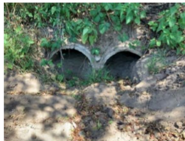
Foto vom 17.06.2020 – Durchlass unter Raiffeisenstraße 2 x DN800 (Auslauf, Durchlass teilw. verlegt)
