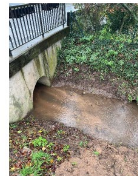
Foto vom 16.11.2023 Tulpenstraße -Pappelweg: hydraulische Probleme und Probleme mit der Kanallage
